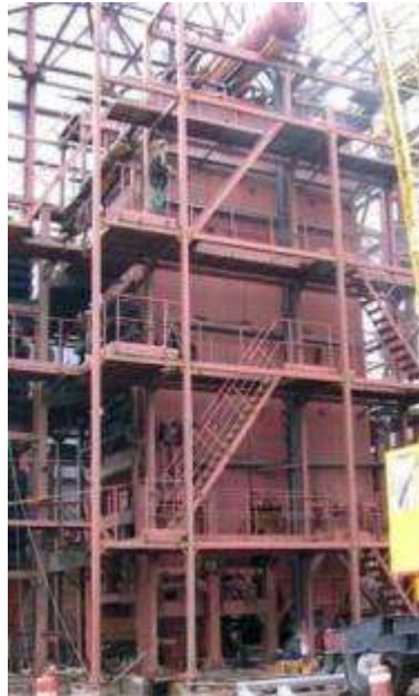
Котел компанії “Енергомашпроект”
